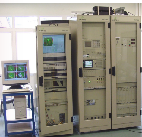
Sala de controle com os bastidores e console de operação
