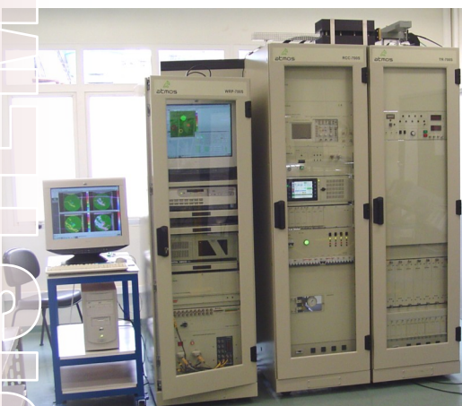
Sala de controle com os bastidores e console de operação
